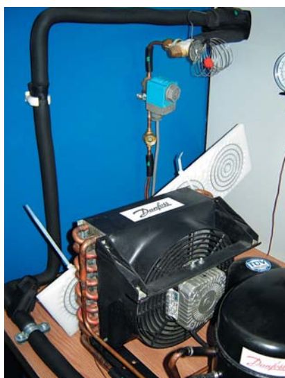
Rys. 3. Polaryzator na skraplaczu oraz polaryzatory pierścieniowe na króćcach agregatu sprężarkowego i u podstawy zaworu dławiącego
