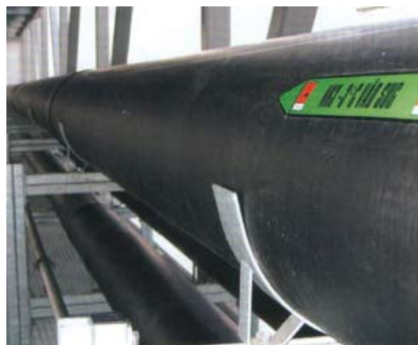
Fot. 10. Główny rurociąg amoniakalny
