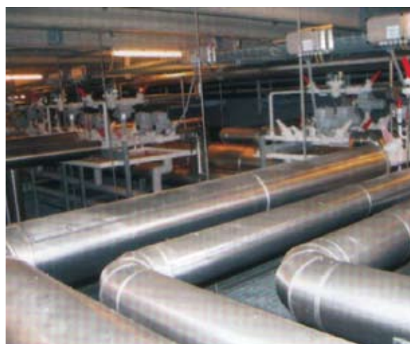
Fot. 11. Przewody amoniaku wraz z zaworami regulacyjnymi
