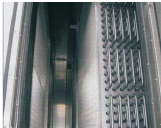
Fot. 6. Powietrzny wymiennik ciepła w centrali wentylacyjnej
