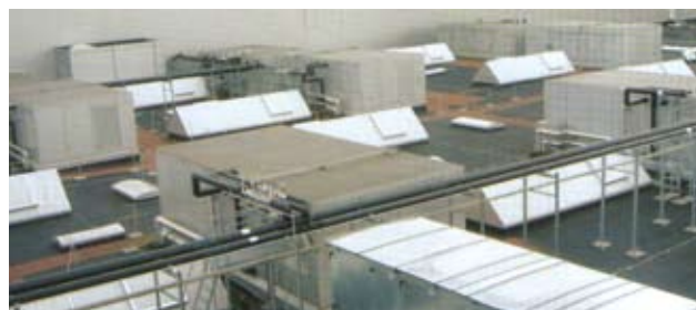
Fot. 7. Centrale wentylacyjne na dachu obiektu
