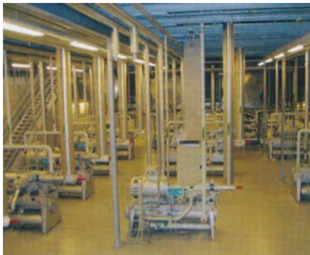
Fot. 9. Śrubowe agregaty sprężarkowe marki Sabroe zainstalowane w układach o temperaturze parowania (od prawej) -3°C, -10°C i -25°C
